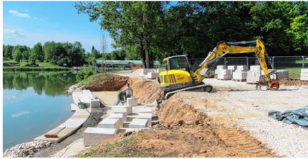
Ein Beispiel für ein erfolgreiches Projekt mit Leader-Förderung in Rainau ist der neue Badebereich mit Spielplatz am Bucher Stausee. Das Bild wurde in der Bauphase aufgenommen. Archivfoto: AK
